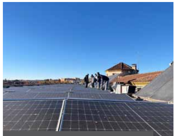
Acompanyament a les instal·lacions del hospital Santa Maria de Lleida amb el grup Talento Joven de Plaques solars
